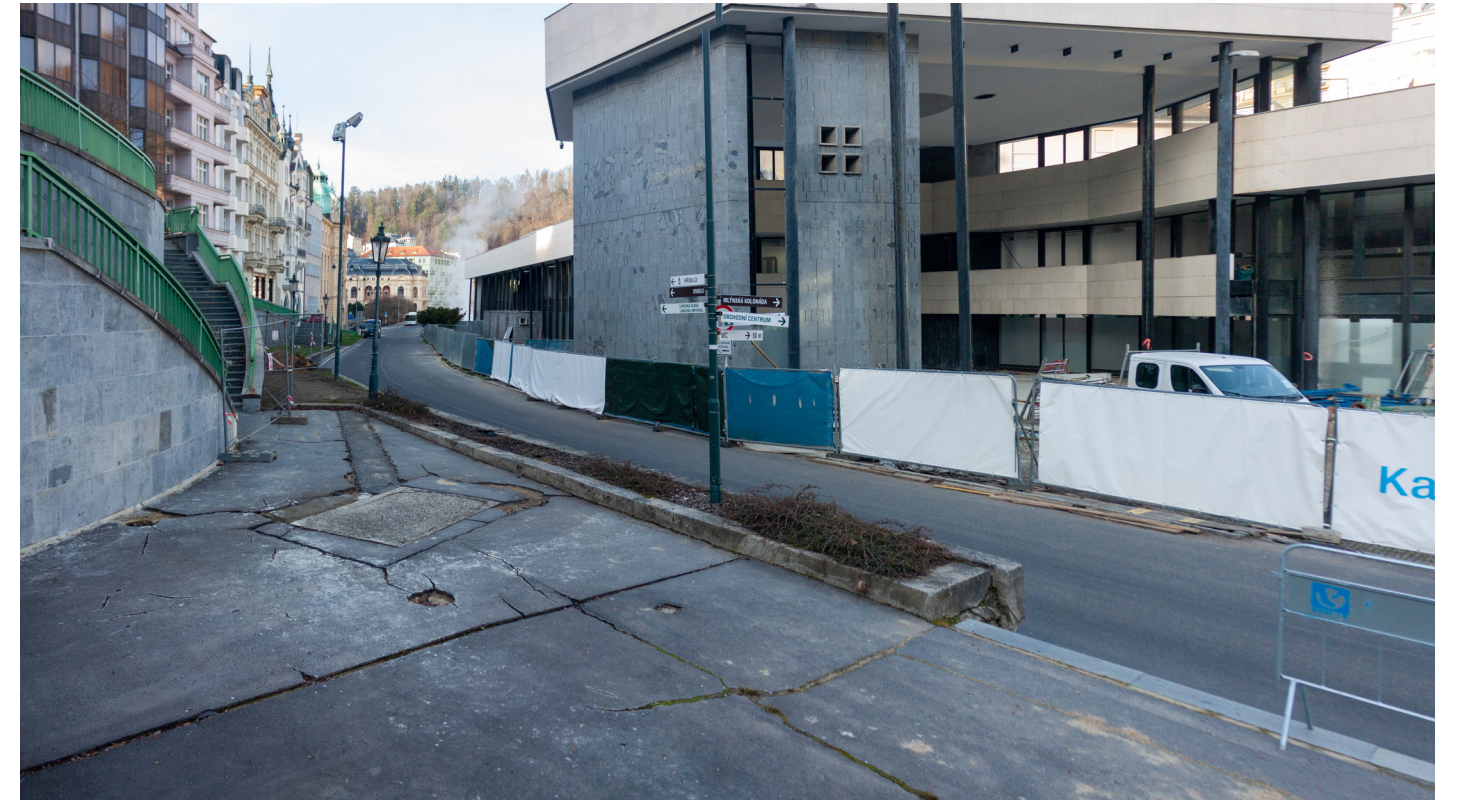
6/ Zcela degradované materiály povrchů
