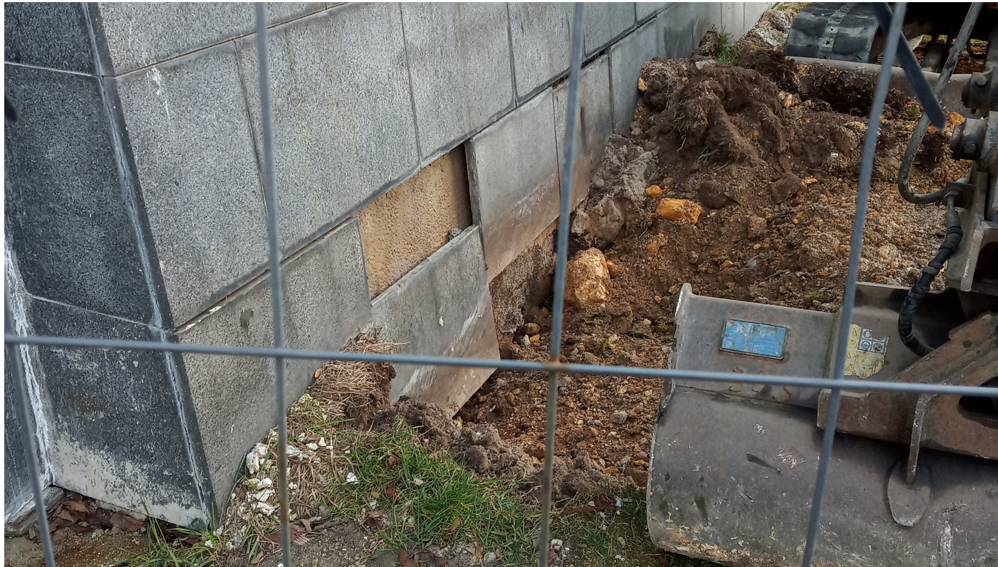
8/ Degradované materiály vyžadující rychlou rekonstrukci
